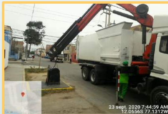
Servicio de Evacuación de Contenedores Soterrados- Av. Víctor fajardo
