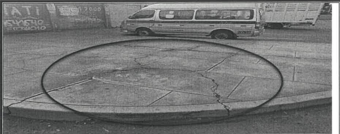
Grietas en veredas de concreto.
