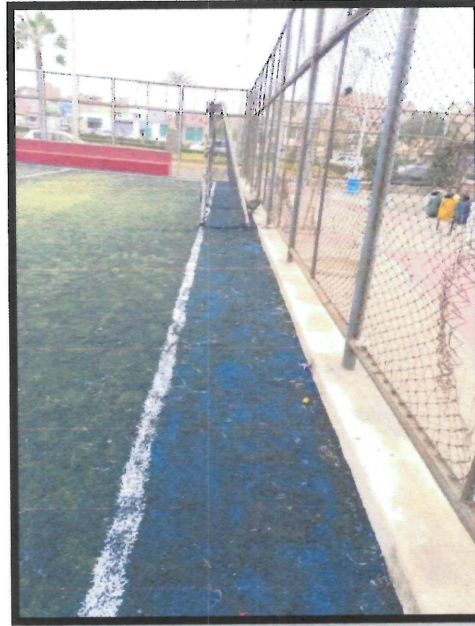
Mallas galvanizadas corroídas.
