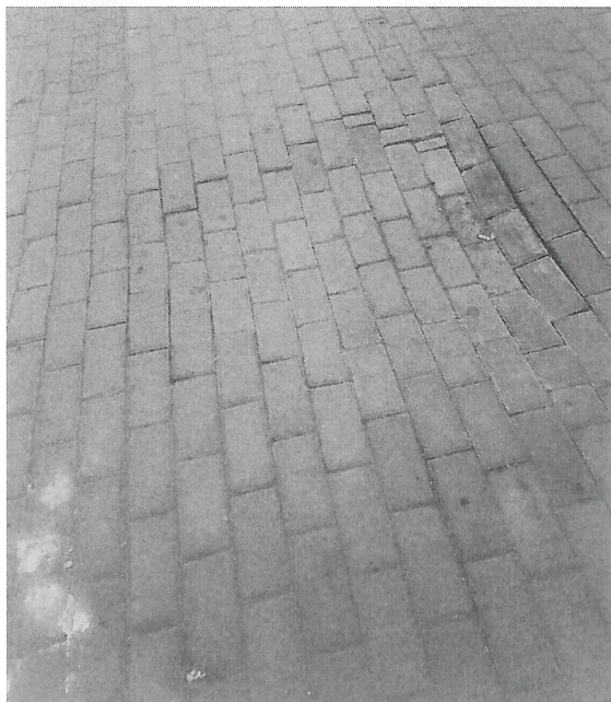
FIGURA 04: Vereda adoquinada en malas condiciones en la Calle CA. 47-D
