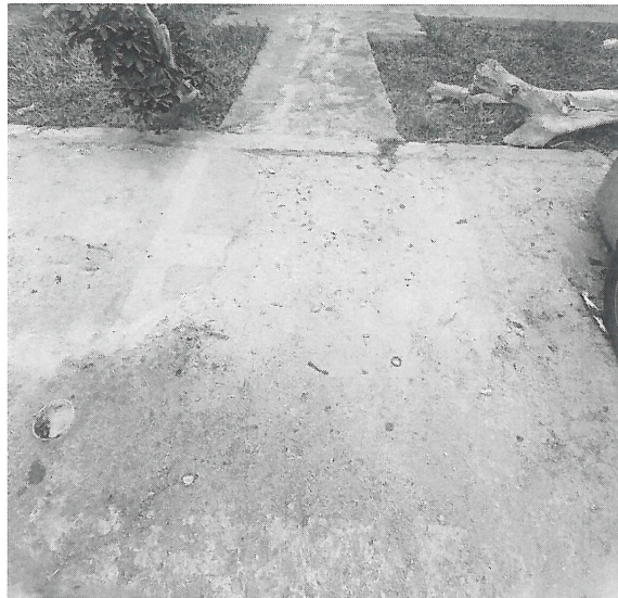
FIGURA 02: Situación actual carpeta asfáltica – Calle 29-A
